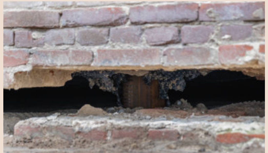
Tussen de fundering en het pand worden, door de toenemende ruimte, ook de palen zichtbaar.
